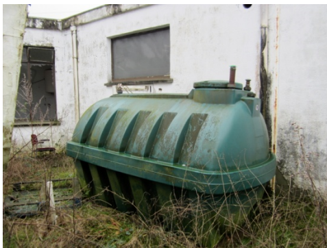
Foto 13: Kunststof stookolietank in binnenplaats
